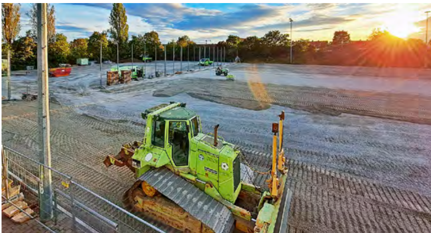
Lasergestütztes Schotterplanum sowie Bearbeiten und Begradigen der Spielfläche für den modernen Kunstrasenplatz mit Kork-Infill
