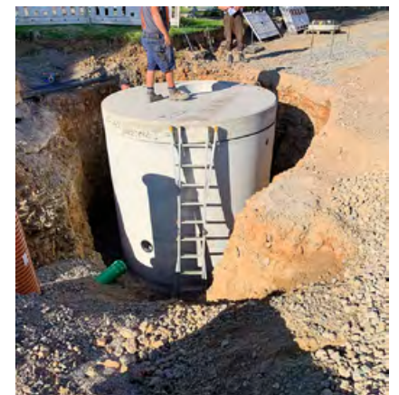
Pumpenschacht mit 60 cm tiefer liegendem Pumpensumpf
