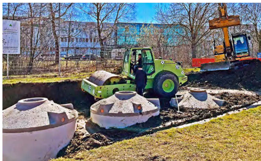
Die dreiteilige Zisterne sorgt für den freien Einlauf und nachhaltige Regenwassernutzung
